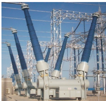
图21 800 kV智能高压开关示范应用
