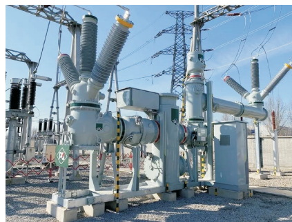
图 20 126 kV 无氟环保型 GIS 示范应用
